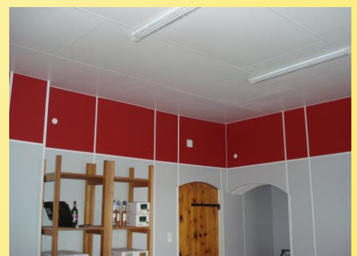
Dusch- und Waschräume glatt, pflegeleicht, fugenfrei; Kellerraum Decke u. Wände mit Isotherm-Innendämmung schimmelsicher
